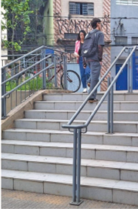
Escada do Metrô com piso escorregadio
